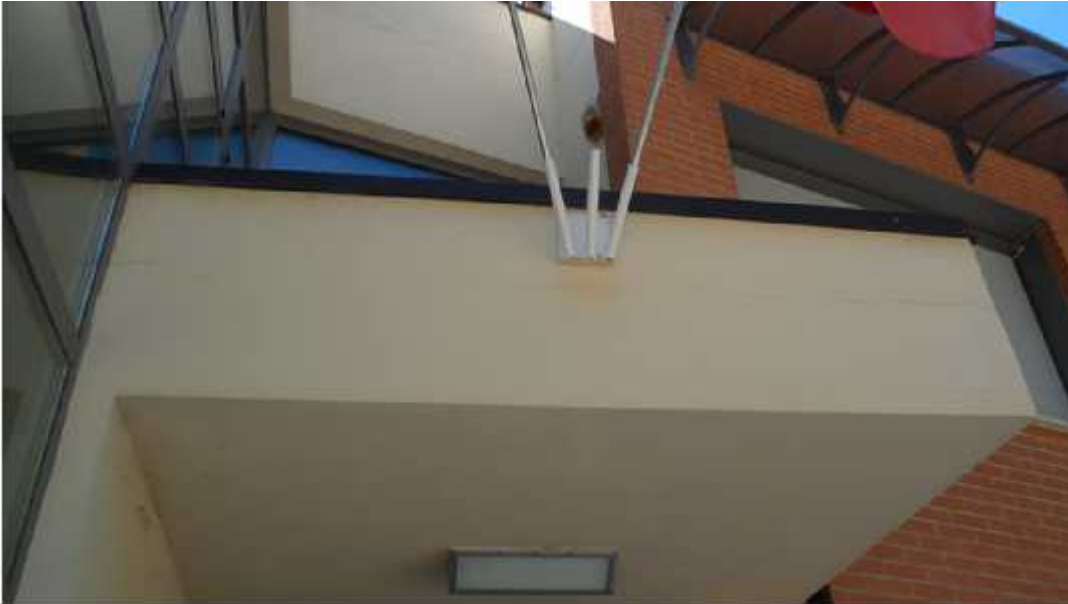
Lesione sull'ingresso principale
