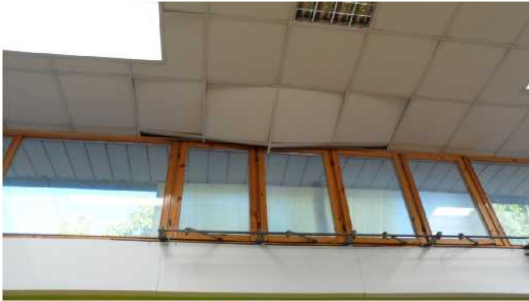
Danno alle controsoffittature
