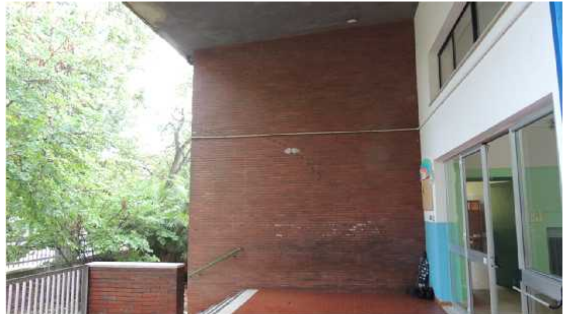
Lesione su parete portante adiacente l'ingresso principale
