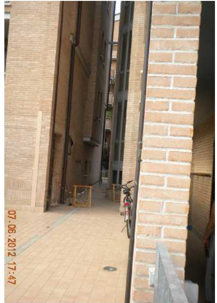
Distacco della cortina su una via di accesso
